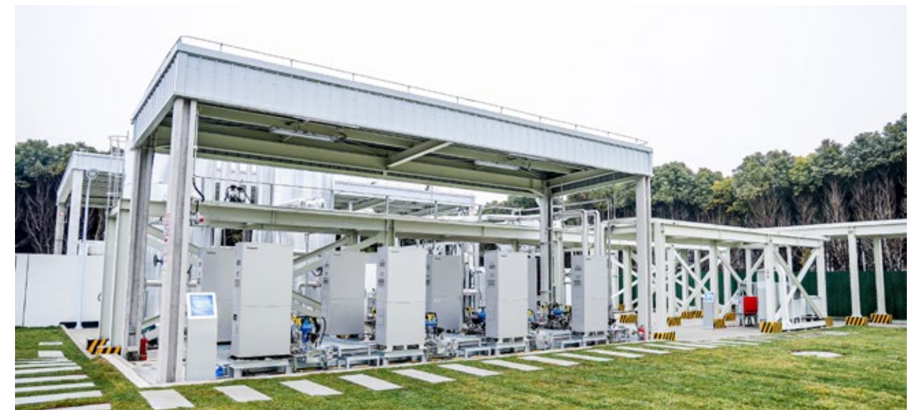
在江苏省无锡市的松下新能源（无锡）有限公司，打造首个氢能燃料电池综合能源利用项目“松下冷热电三联供氢能示范项目”。
