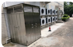
松下中温3HP、低温4HP涡旋压缩机以高可靠性、低运行噪声为广东省多个地区的疾控中心疫苗库提供支持，助力疫苗储存
