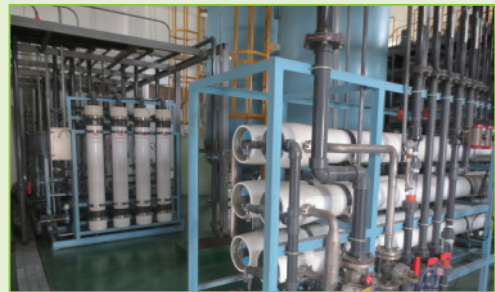
松下能源（无锡）有限公司废水回收再利用系统
